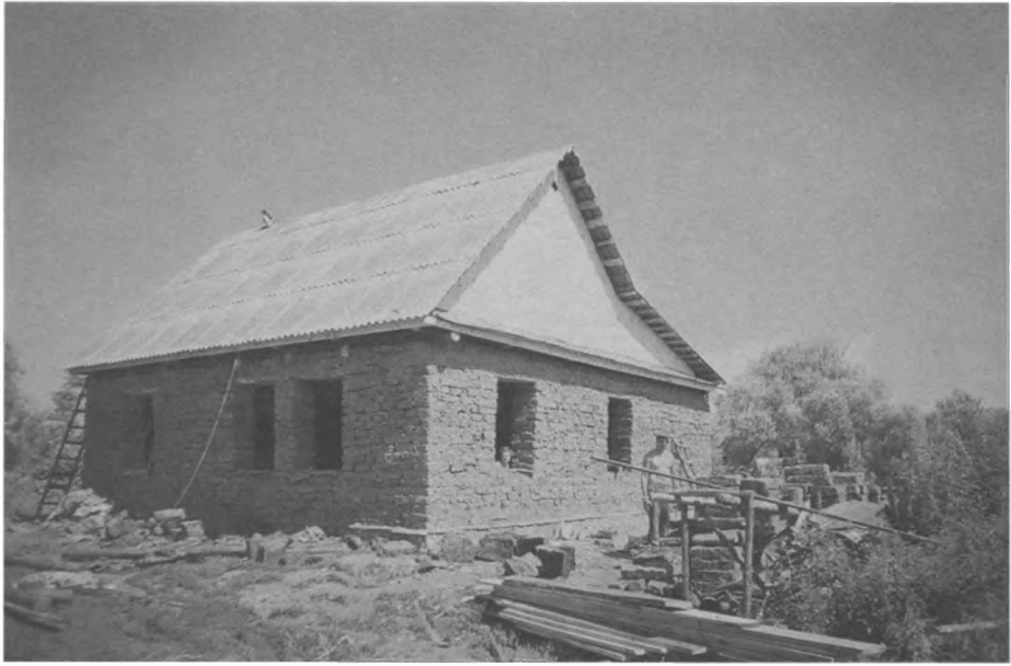
Строительство дома из саманных кирпичей. С. Пронькино, Сорочинский р-н, Оренбургская обл. Фото Е.А. Ягафовой. 2000 г.
